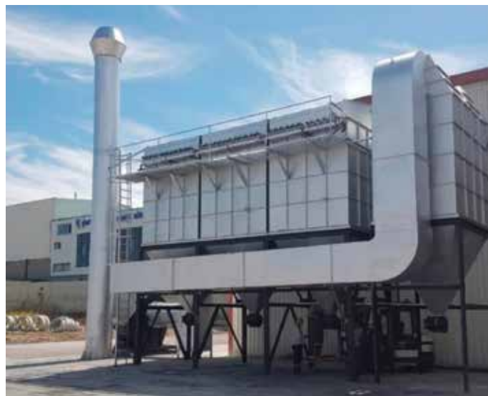
System filtracji spalin. ALM Company
